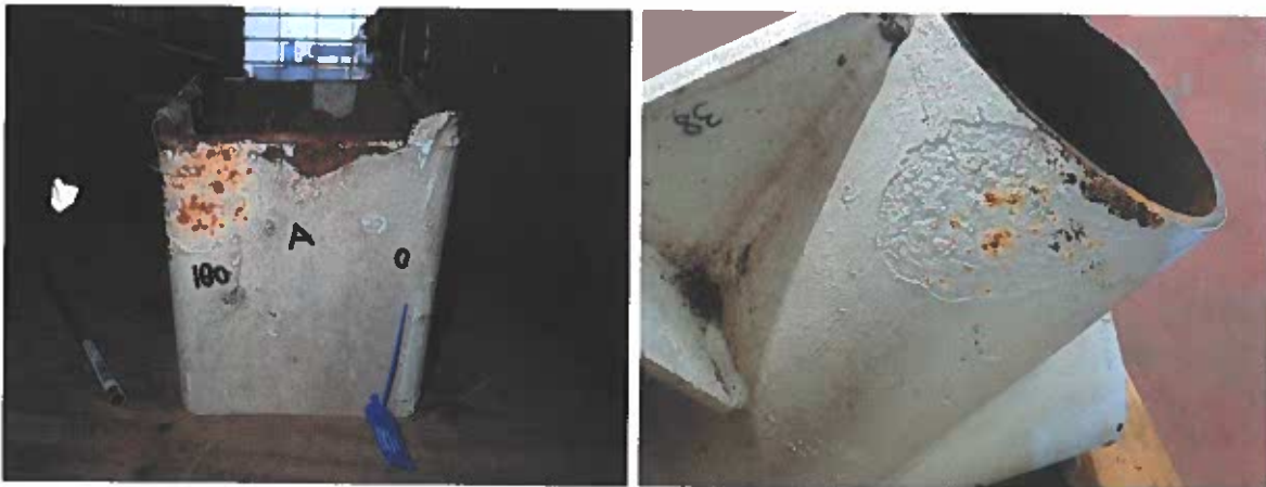
Figuur 14: Bij de bezweken spanten was op diverse plaatsen sprake van aanzienlijke corrosie; veelal was ter plaatse de uit verf bestaande coating wel bijgewerkt, maar vaak over de roest heen. (Bron: SGS Intron B.V.)
