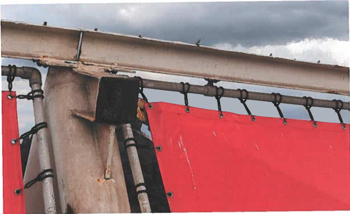
Figuur 15: In 2019 was roest op verschillende plaatsen rondom de verbinding zichtbaar ondanks het schilderwerk uit 2015, zoals te zien op deze foto van het bovenste knooppunt van spant 40 genomen enkele dagen na de instorting. (Bron: Onderzoeksraad voor Veiligheid)
