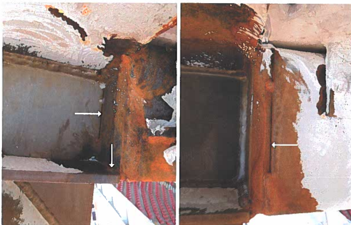
Figuur 13: Bij drie spanten (die niet bezweken zijn) ontbraken delen van lassen. Bij twee ging het om de verbinding tussen de kopplaat en het H-profiel (linkerfoto) en eenmaal om de verbinding tussen de kopplaat en de koker (rechterfoto). Voor het onderzoek is lokaal de verf verwijderd. (Bron foto's: Royal HaskoningDHV)
