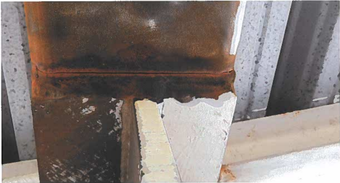
Figuur 16: Bij zes spanten werden in de verbinding van de bovenregel scheuren in de lassen aangetroffen. Deze foto toont de scheur in de verbinding van spant 43. Voor het onderzoek is de verf verwijderd. (Bron: Royal HaskoningDHV)
